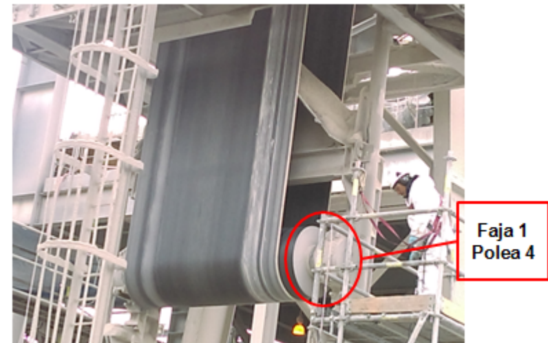
Mancais do contrapeso da esteira 1
